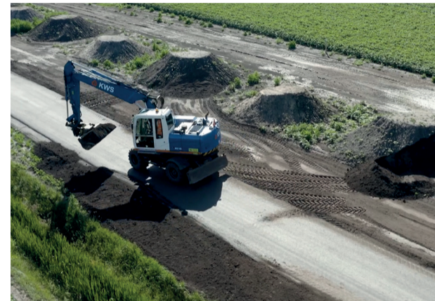
Bestaande wegen werden opgevaardeerd en binnen het windpark werden vele kilometers toegangswegen aangelegd.
